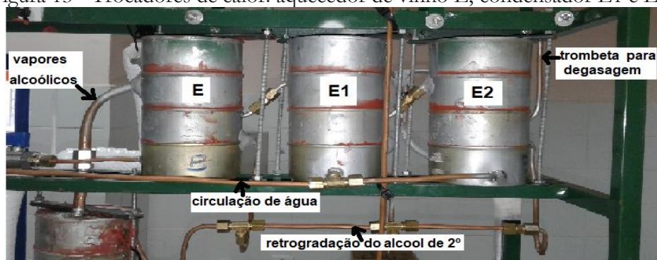
Figura 13 - Trocadores de calor: aquecedor de vinho E, condensador E1 e E2.
