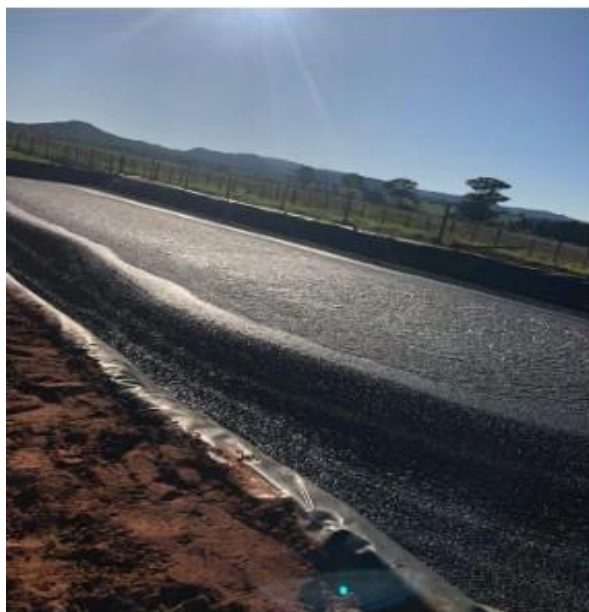
Figura 1: Lagoa de estabilização
