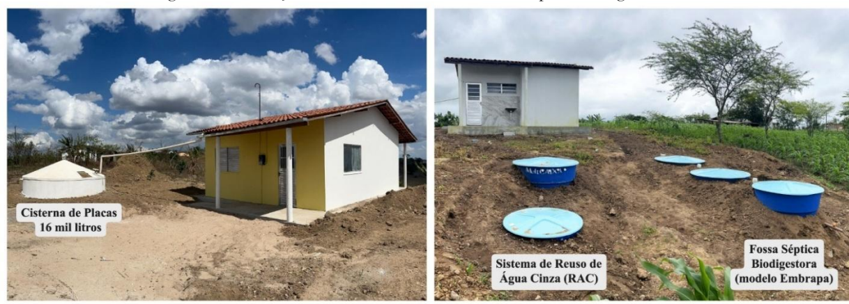
Figura 5 – Habitação com Cisterna de Placa, Fossa Séptica Biodigestora e Sistema RAC
